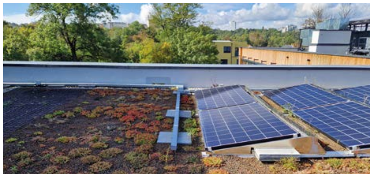
Příklad bio-solární střechy, budova školy Praha 9, © Ecoten
